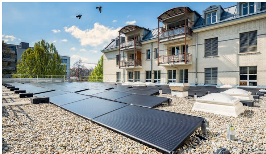
Photovoltaik-Anlage Haus 33, Kantonsspital St.Gallen (KSSG)
